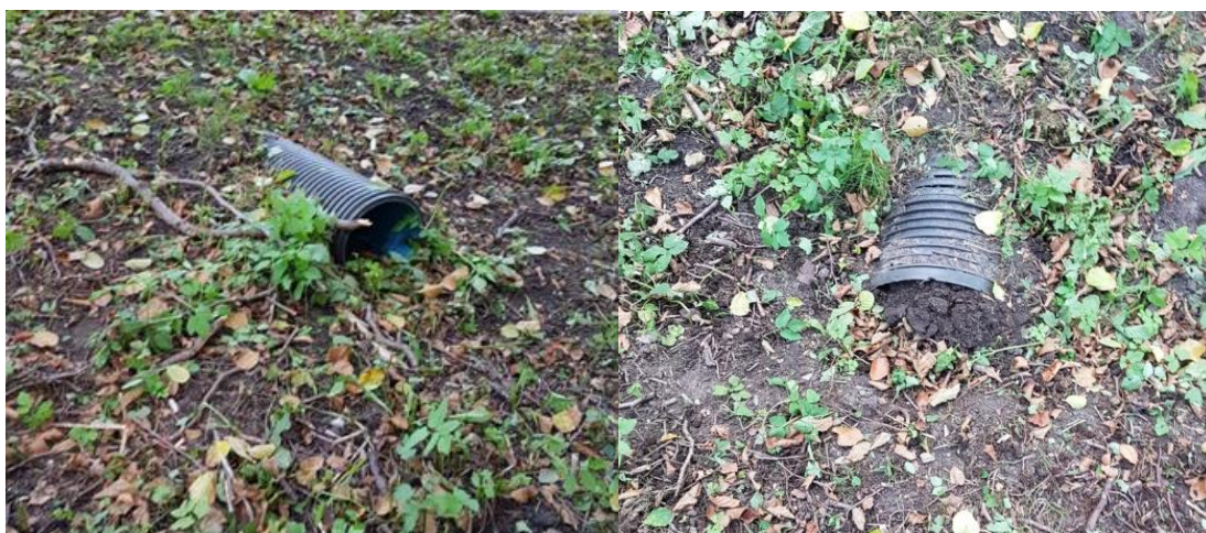
57.,58.att. Esoša daļēji un pilnībā aizbirusi caurteka [Avots: autora uzņemta fotogrāfija].
