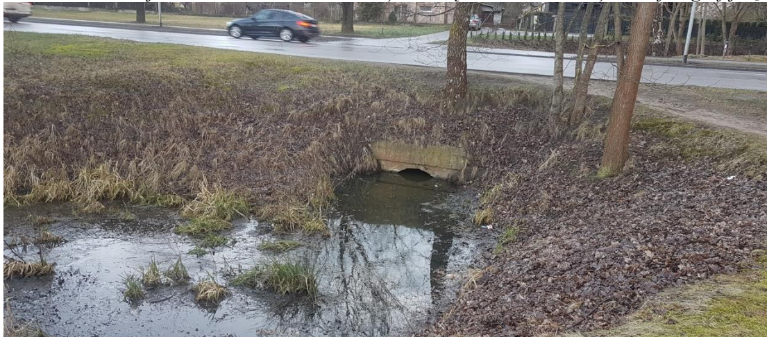
63.att. Caurtekas zem Tēriņu ielas [Avots: autora uzņemtas fotogrāfijas].
